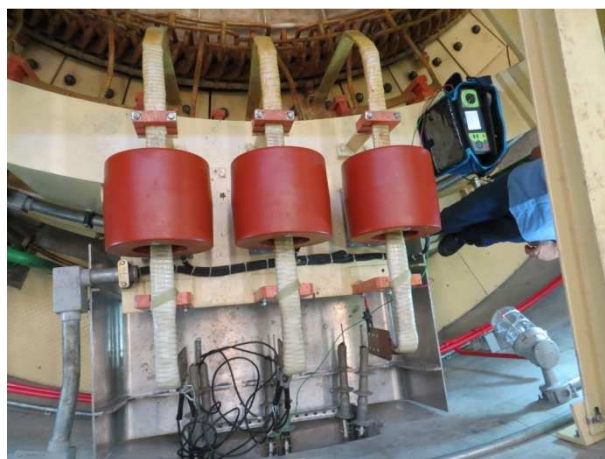
Figura 5: Ensaio elétrico no gerador.
