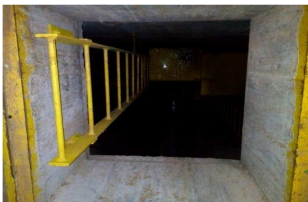
Figura 10: Poço de drenagem.
