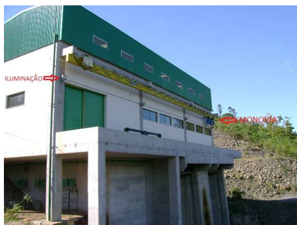
Figura 12: Iluminação da casa de força e monovia.
