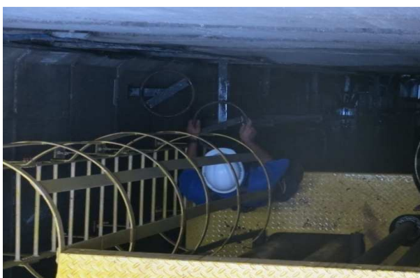
Figura 11: Poço de esgotamento, manobras para esgotamento da caixa espiral.
