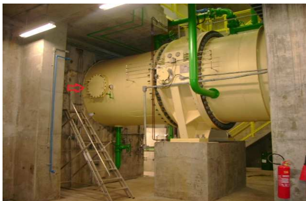
Figura 9: Escotilha de acesso a caixa espiral.
