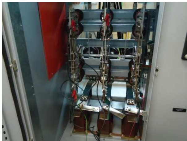
Figura 4: Seccionadora dentro do cubículo.
