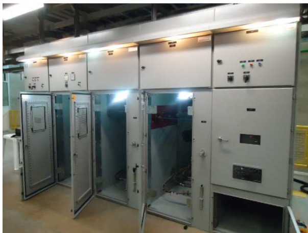
Figura 1: Cubículo de média tensão desligado e aberto para manutenção.
