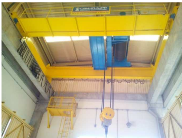
Figura 6: Ponte rolante com capacidade de carga de 50 toneladas.
